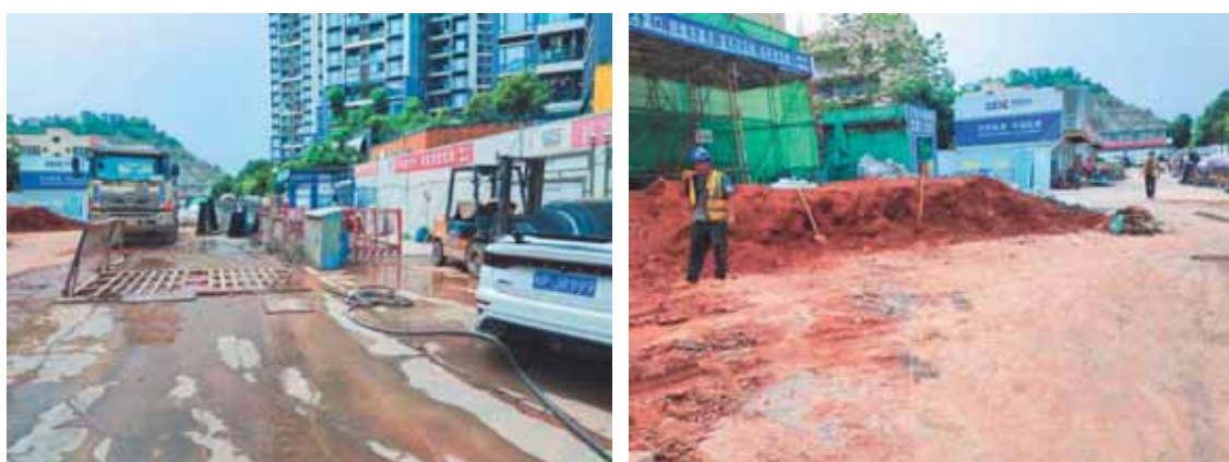
路面硬化及临时裸土
