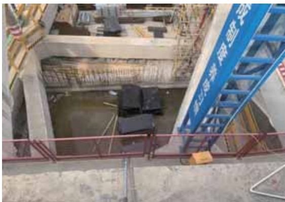
基坑蓄水抽排设施
